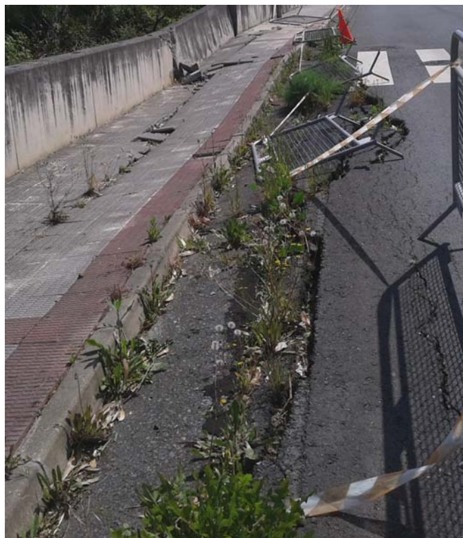
4. Traza de la zona afectada
