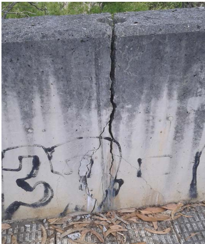
12. Daños en la estructura del muro
