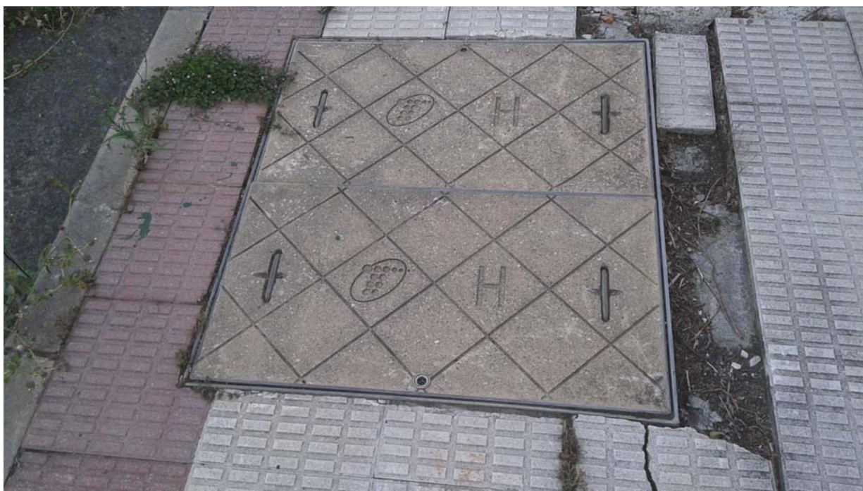
11. Arqueta de telefonía
